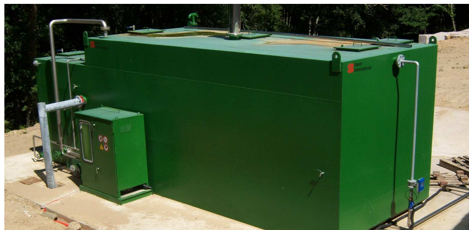
EDAR compacta en SOUTELO DE MONTES-Forcarei (500 h.e.)
