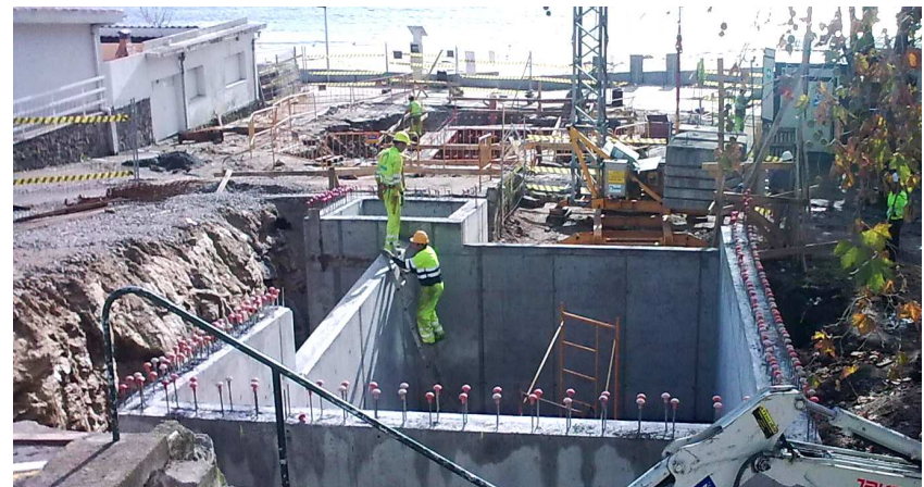
Tanque de tormenta en Louro (MUROS)-120 m³
